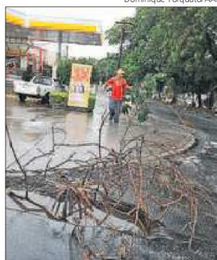
Cratera = Buracão no asfalto
