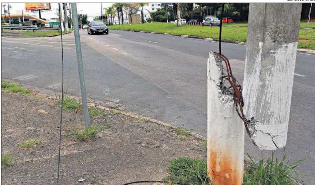
Poste quebrado após ser atingido por carro na Avenida John Boyd Dunlop, altura do Jardim Aurélia, em Campinas: acidente comum na cidade
