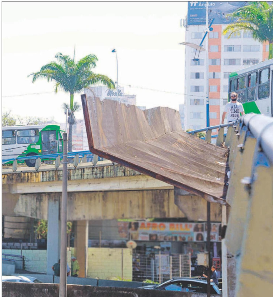
Defensa no entorno do Viaduto Cury, estrutura antiga e de difícil troca: limite de velocidade foi reduzido e radar instalado em trecho estratégico
