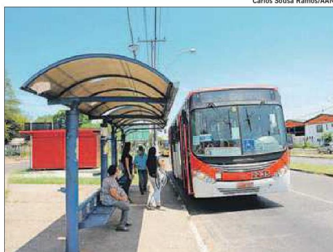
No Jardim Florence, estrutura de alumínio com cobertura danificada
