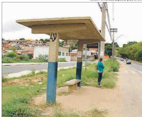
No Satélite Iris, estrutura de concreto igual a que causou uma morte
