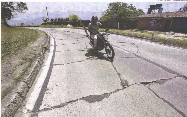
Problema visível. Asfalto rachado na BR-040: obras que melhorariam as condições da rodovia estão paradas
