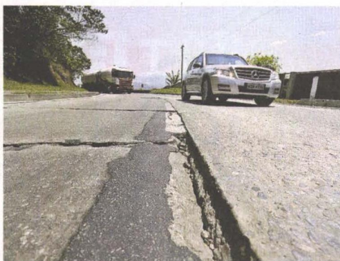
Perigo no caminho. Mau estado de conservação aumenta risco de acidente
