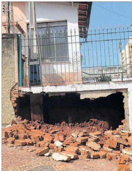
Muro de casa não resistiu à força da água e caiu na R. Emílio Henking
