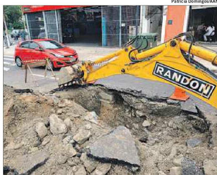
Chuva abriu cratera na Avenida Francisco Glicério: parte do asfalto cedeu
